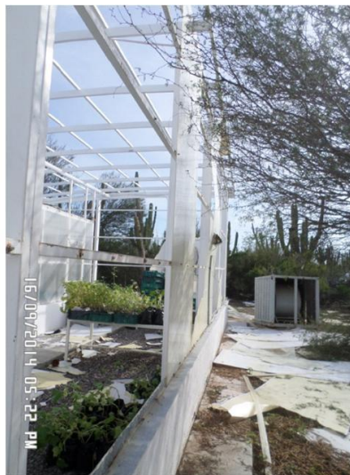
Fotografías del daño causado en el invernadero del CIBNOR
